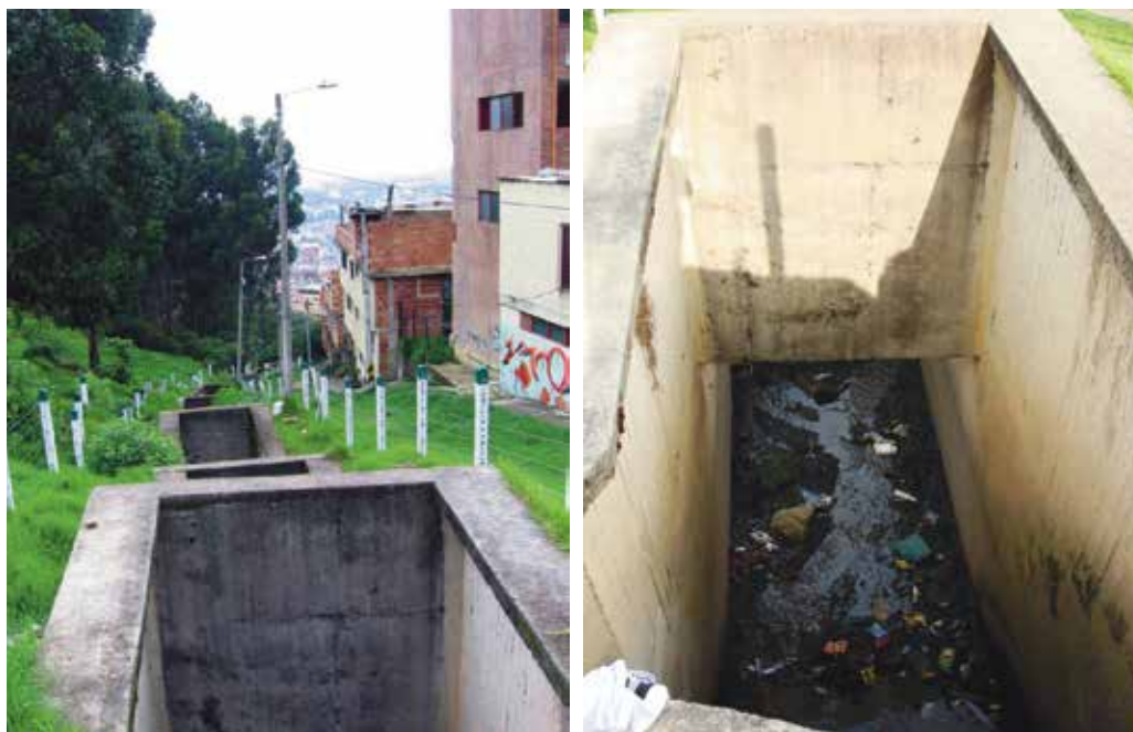
Figura 2.8 Tramo canalizado del “sistema de drenaje 1” de Pardo Rubio.
